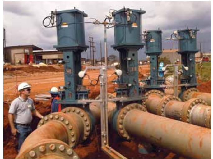
Cuatro válvulas de cuchilla de servicio severo clase ASME en servicio de lodos en una mina de cobre.
