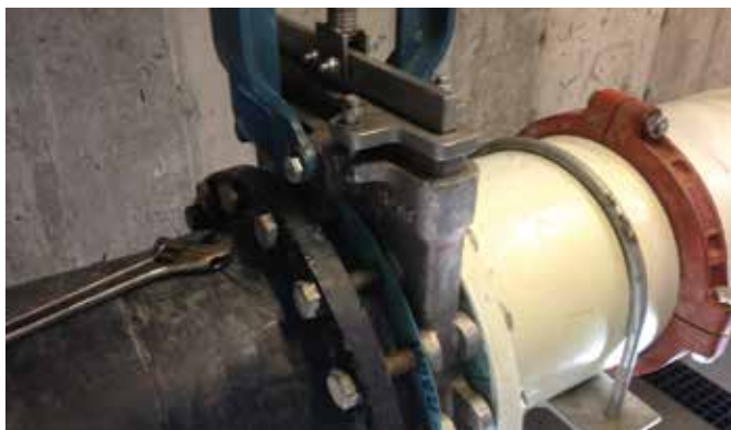
Válvula de cuchilla DeZURIK en una línea de recuperación de agua subterránea/poza.
